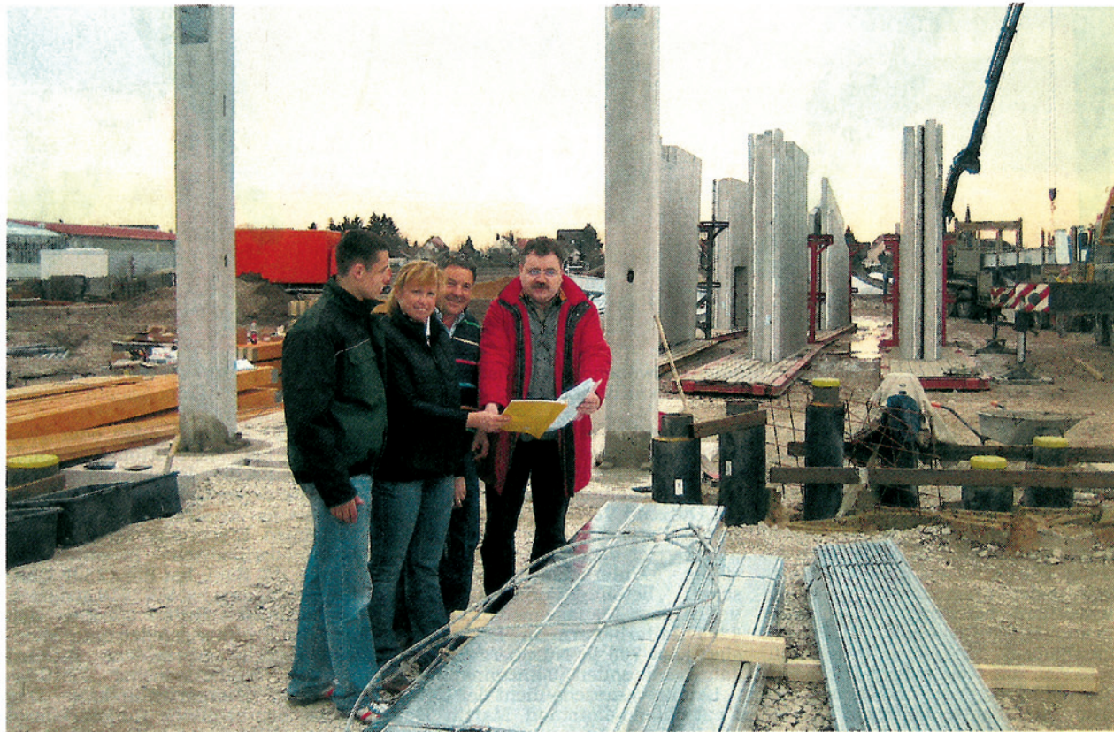
Stefan, Eva und Peter Scherzer stehen mit Projektplaner Wolfgang Windisch auf der Baustelle des Kraftwerks. Foto: Voigt
